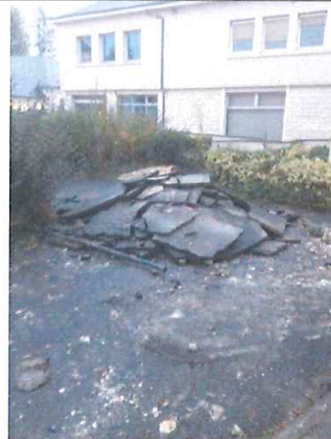
Zone de stockage des enrobés
