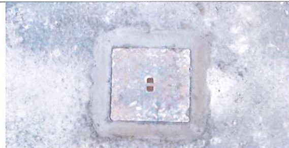
Mise en place d'un tampon hydraulique en remplacement de la bouche à clé abîmé de Pz1
