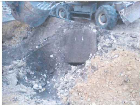
Découverte d'un ancien puisard dans les remblais
